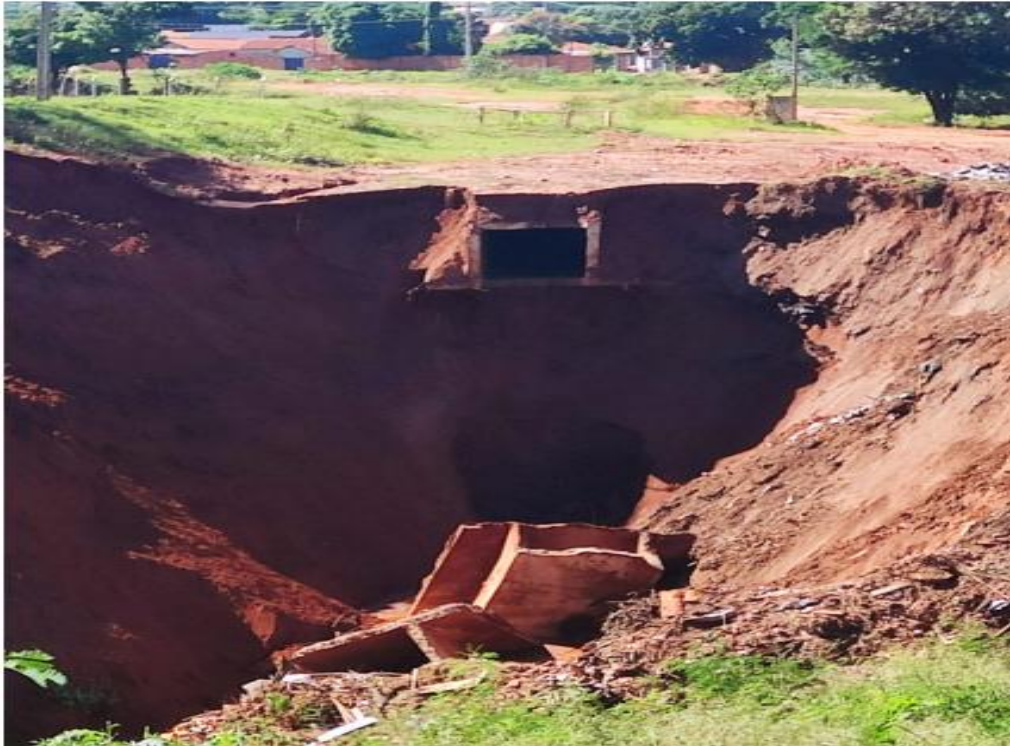
Macro drenagem em processo de destruição.
